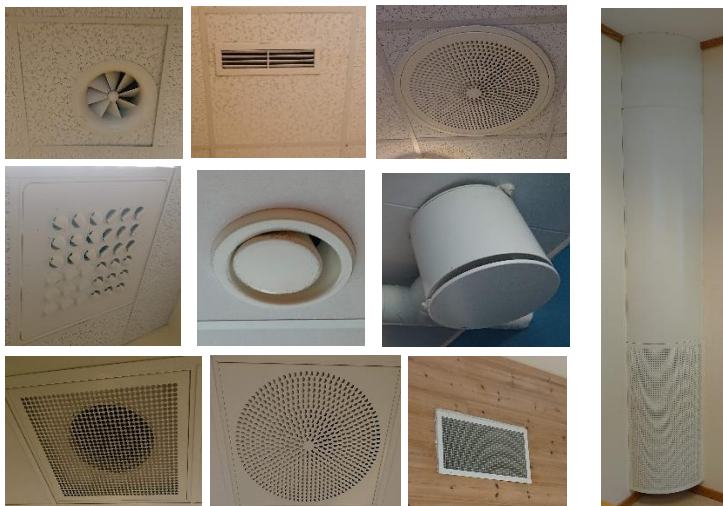
Bilde 328: Forskjellige tillufts- og avtrekksventilar på skulen.
