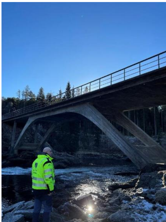
Figur 45: Bilete av dagens bru frå befarings. Bilete henta frå Konstruksjonsrapport, Asplan Viak AS.
