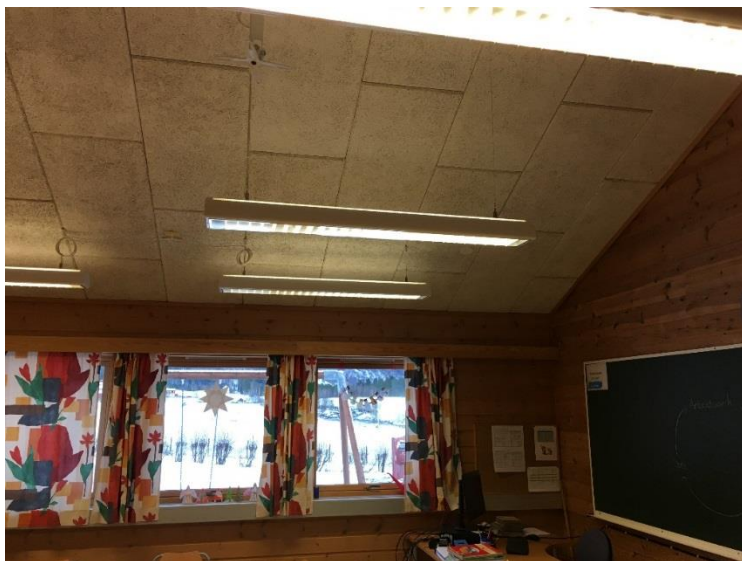
Bilde 418: Lysarmatur i klasserom i adm. bygg.
