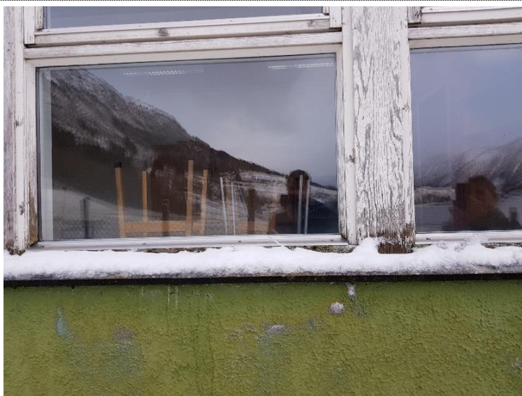
Bilde 206: Manglande vedlikehald på vindauge, må gjere strakstiltak for å unngå utskifting.
