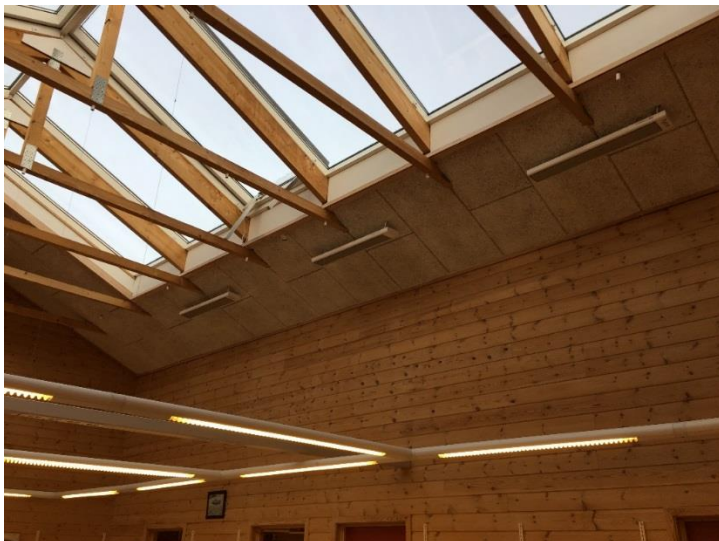
Bilde 409: Elektrisk takvarme i bibliotek adm. bygg.
