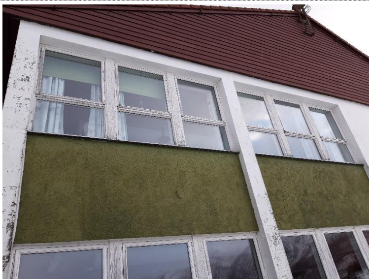
Bilde 215: Manglande solavskjerming på vestfasade, gamlebygget.
