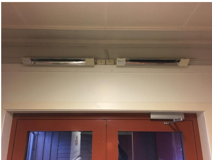
Bilde 413: Strålevarme ved inngang gamlebygget. Ok tilstand.
