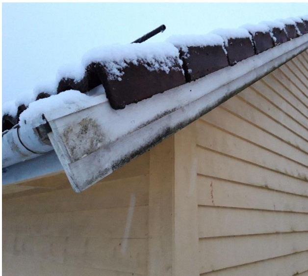
Bilde 203: Behov for vask og maling.
