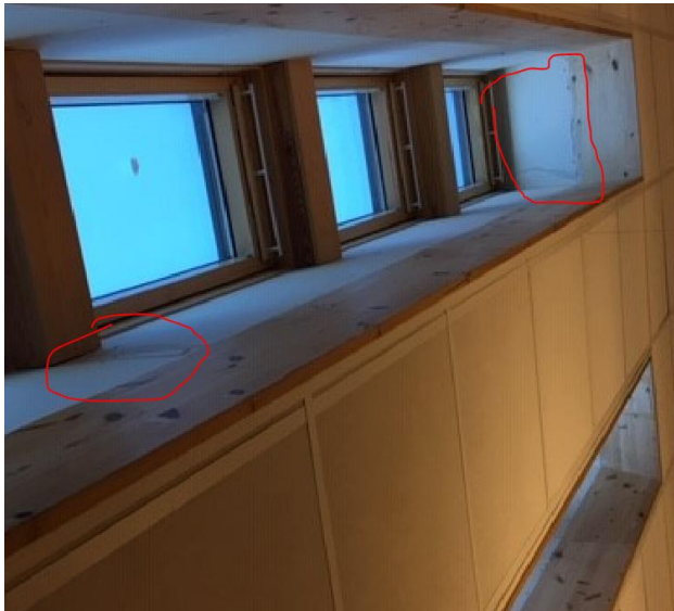
Bilde 211: Skjolder etter lekkasje
