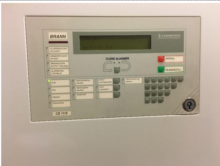
Bilde 414: Brannsentral frå byggeår.
