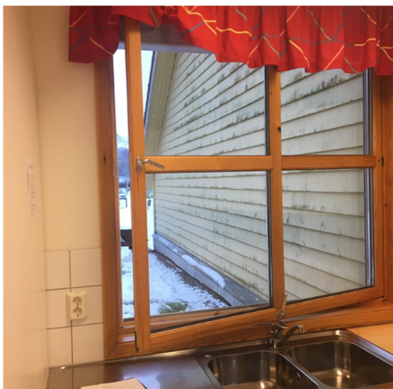
Bilde 213: Rømmingsvindauge er ikkje opningsbart pga. plassering av vask.
