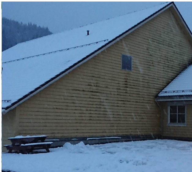
Bilde 202: Behov for vask og maling.
