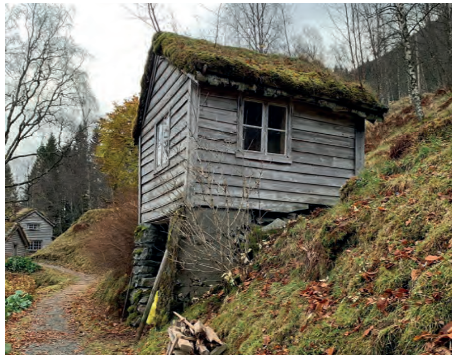
Bestastova var ved oppstart av restaurering november i 2020 i dårlig forfatning. Taket ble holdt på plass med lastestropper. Søndre/ bakre del (til høyre) ble tatt av ras på 1940-tallet.
