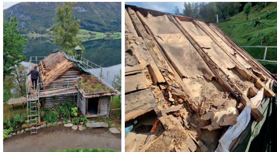
Det åpenbarte seg en hel del råteskader da taket ble åpnet opp.
