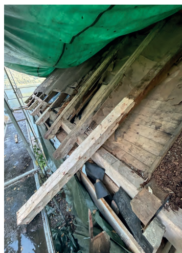
Råtne sperreender ble spunset.
