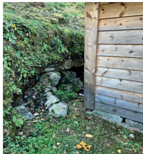
Det blir i fortsettelsen viktig å sørge for tilstrekkelig lufting mellom bygg og terreng, spesielt mot sør.
