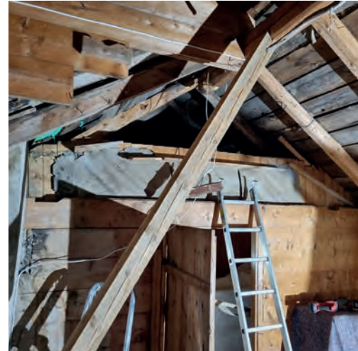
Deler av loftskonstruksjonen bar sterkt preg av lappverk.
