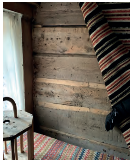
Nordvegg på kjøkkenet. Sprekkene mellom laftet er tettet fordi det har vært montert papp her tidligere.
