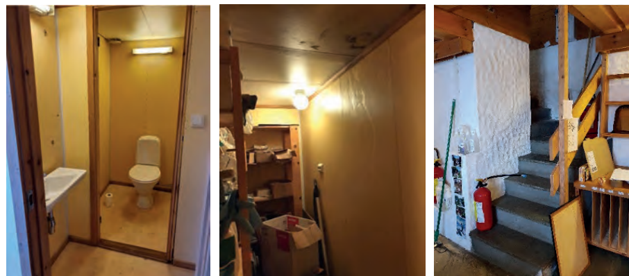
Under utflytting og rivning kom det frem mange spor etter tidligere vannskader
